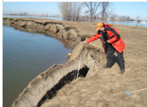
Effondrement des sols en surface à la suite de la gélifraction des parois argileuses
